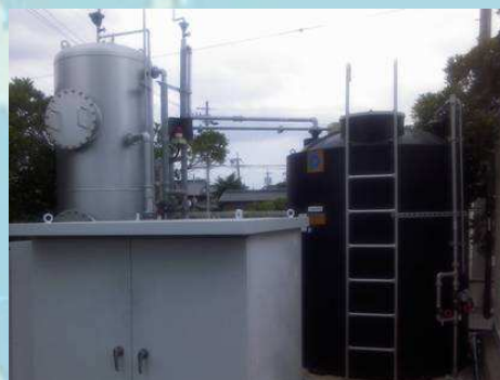
地下水のろ過装置とタンク
